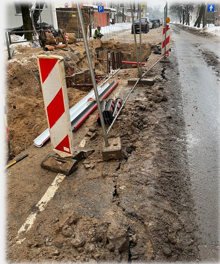
Asfaltbetona malu lūzumi gar būvbedres malām
